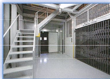
10m法電波暗室地下の 搬出入用エレベータ
