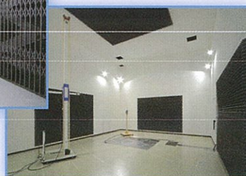
3m法電波暗室内部
