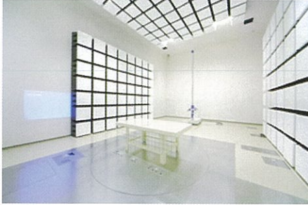
3m法電波暗室内部
