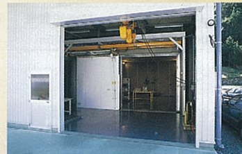
大型電波暗室搬入口
